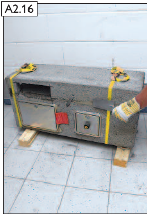
Fuge auf Vorder- und Rückseite vollständig und dicht nachspachteln.
