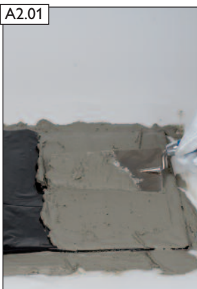
Mörtelbett MG(M5) IIa (Mauermörtel nach EN 998-2) für Fertigfuß und Lüftungsmodul vorbereiten, Feuchtesperre einlegen, Mörtel auftragen.
