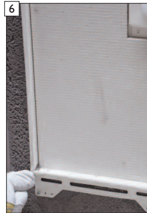
6 Ansicht unterer Türscharnierbereich mit bauseits zurückgeschnittener Schutzdichtung im Bereich des Türscharniers.
