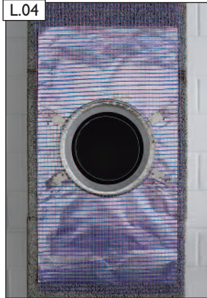
Ansicht Feuerstättenanschluss mit eingebautem Schiedel Edelstahl-Anschlussfutter:
