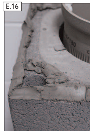
E.16 ACHTUNG! Auf geschlossenen Stegbereich achten!
